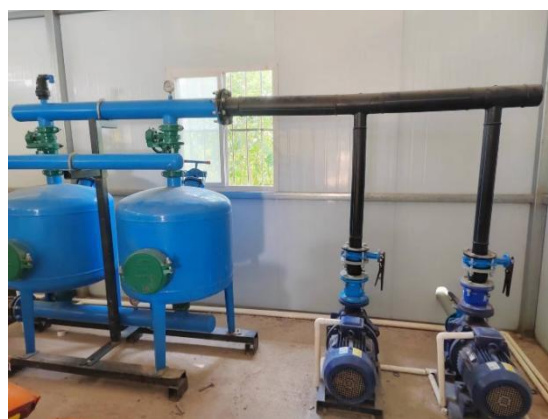
水肥一体化设施
